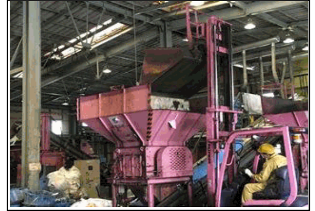
③施設への産業廃棄物の投入状況
